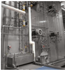
External fan motors
